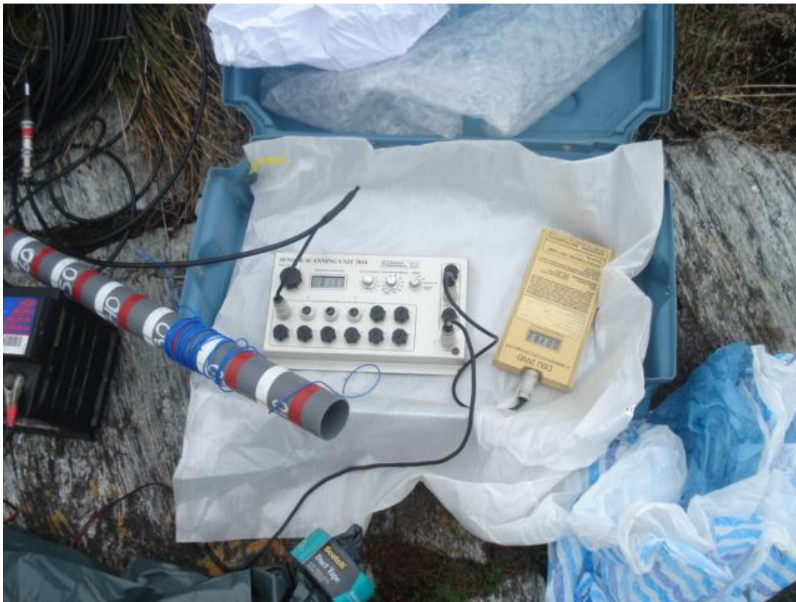
Figura N°28 Mareógrafo AANDERAA instalado en Río Queule. Febrero- Marzo de 2014.
