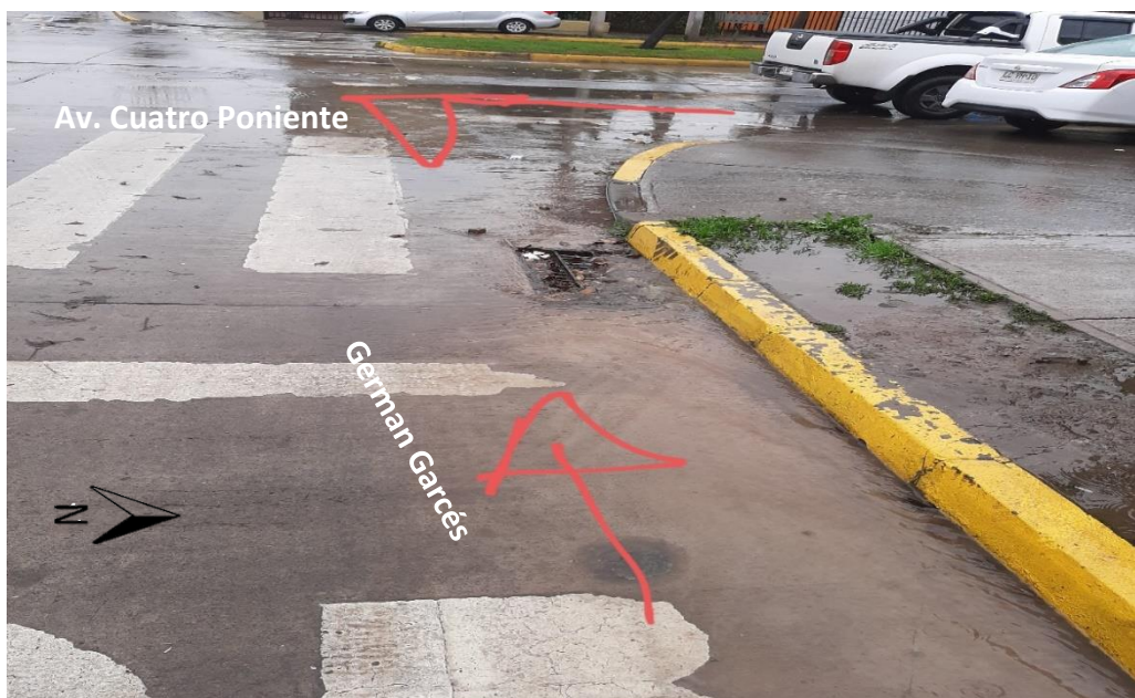
FOTOGRAFÍA 4-14: SUMIDERO PARCIALMENTE TAPADO UBICADO EN GERMAN GARCÉS CON EL CONQUISTADOR. HORA; 10:28
