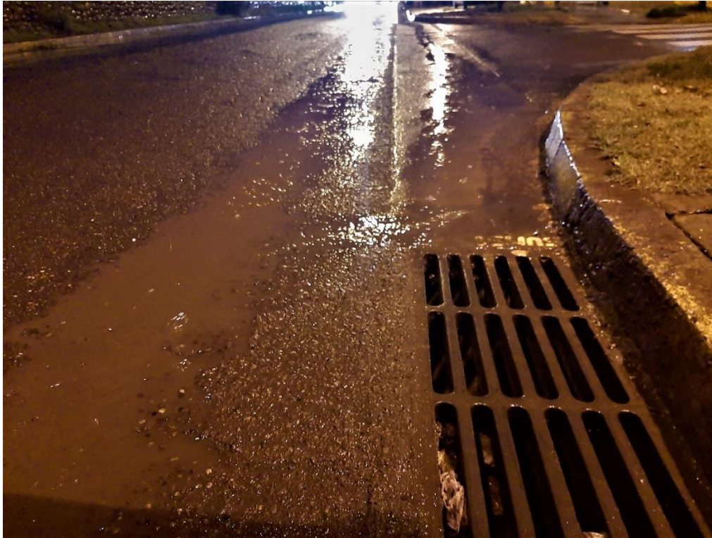
FOTOGRAFÍA 4-15: ALFREDO SILVA CON CERRO BLANCO; SUM 51. VISTA CONTRARIA A LA DIRECCIÓN DE ESCURRIMIENTO. HORA: 20:38
