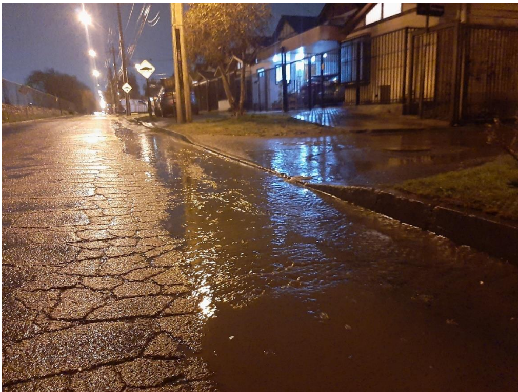
FOTOGRAFÍA 4-13: ALFREDO SILVA CON HNOS. GRIMM. VISTA CONTRARIA A LA DIRECCIÓN DE ESCURRIMIENTO. HORA: 20:35 ; ANCHO 1.2 M
