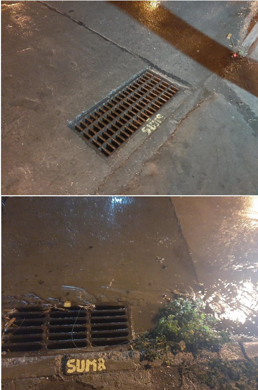
FOTOGRAFÍA 4-40: SUMIDERO 8 Y 9 UBICADOS EN HÉCTOR FUENZALIDA; ESCURRIMIENTO SOLAMENTE EN SUM 8 (IZQUIERDA).
