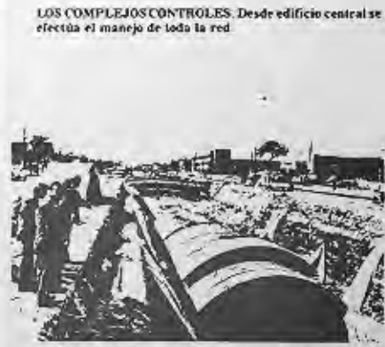
UNA OBRA GIGANTESCA. Remoción subterránea que ha dado trabajo, en sus diferentes etapas, a 40 mil personas.
