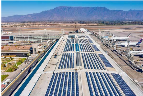
Figura 6-32: Paneles solares en aeropuerto AMB
