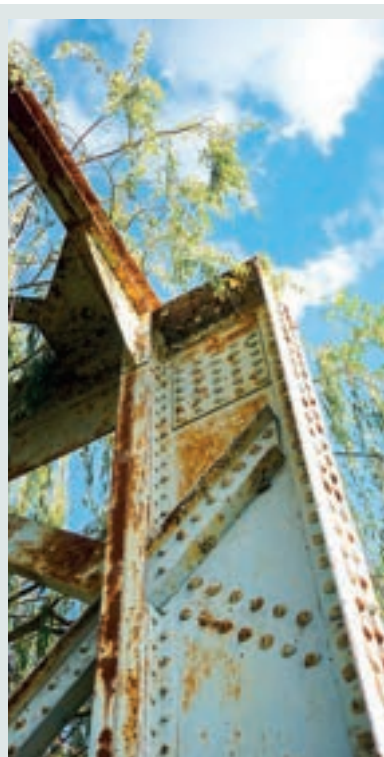
Detalle del óxido presente en la estructura.
