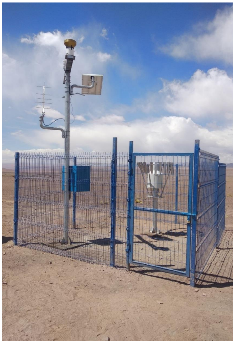
Figura 5-2: Estación Meteorológica Quebrada Caya Instalada.
