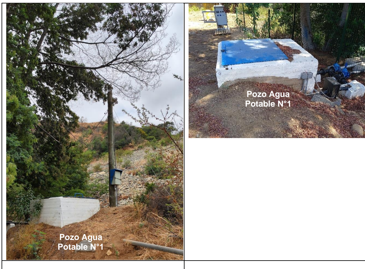
Figura 6.15 - Poste eléctrico con tablero y cámara de hormigón protección de pozo agua potable N°1
