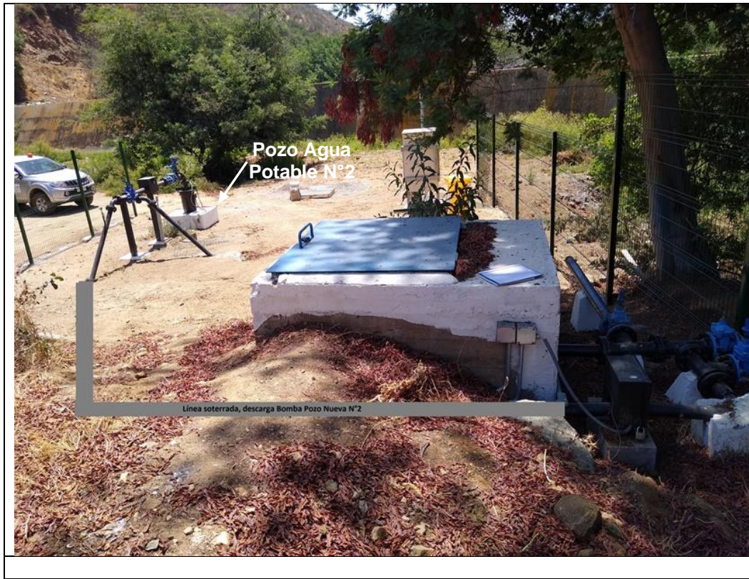
Figura 6.16 - Pozo agua potable N°2 con su línea de descarga soterrada y pozo agua potable N°1
