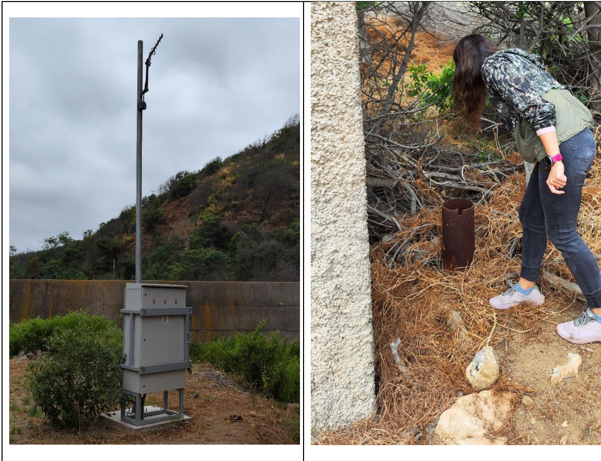
Figura 6.18 - Tablero eléctrico telemetría y caseta y pozo en desuso
