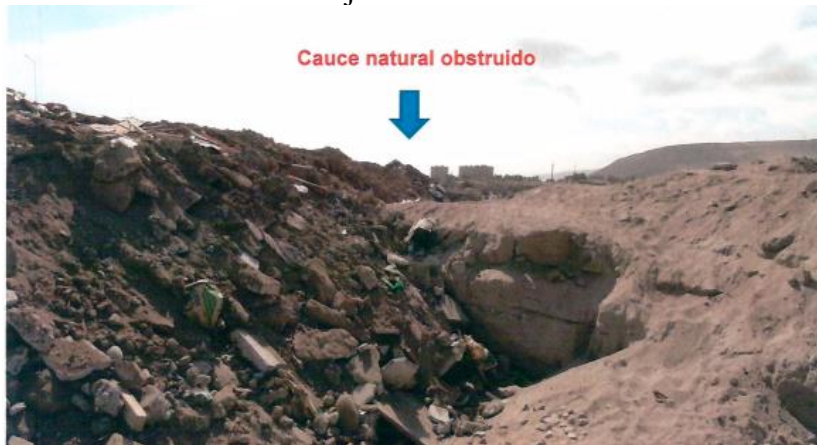
Figura 1-25. Vista de material por sobre la cota natural de la quebrada de Acha, registro de fecha 12 de junio de 2017.
