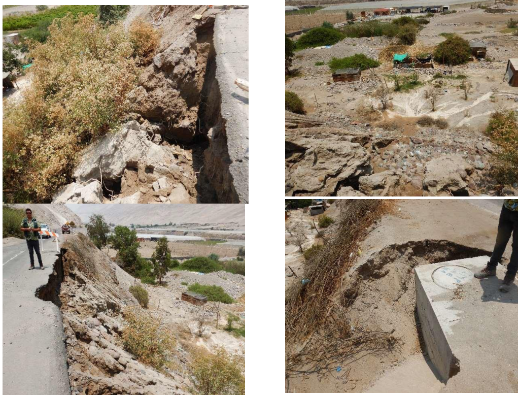
Figura 1-14. Sector km 36 de la ruta A-27 (Sector altamente erosionado por lluvias. Presencia de cárcavas y surcos).
