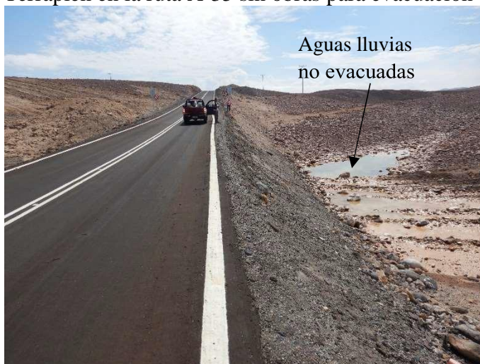
Figura 1-17. Terraplén en la ruta A-35 sin obras para evacuación de aguas u obras de arte.
