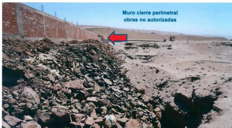
Figura 1-28. Vista actual de obras en cauce y cierre perimetral del sector intervenido, registro del 01 de diciembre de 2017.
