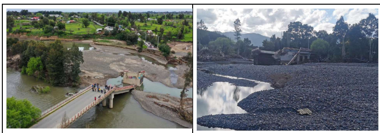
Imagen 4.2: Estado del puente Maitenhuapi luego de las crecidas del año 2023. Fuente: Presentación Dirección de Vialidad Cambio Climático Aplicación a Puentes.
