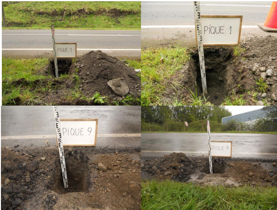
Figura 8-1: Pique al Borde de una Calzada Pavimentada
