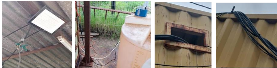
Figura 8-26: Fotos condiciones subestándar de conexiones y canalizaciones eléctricas
