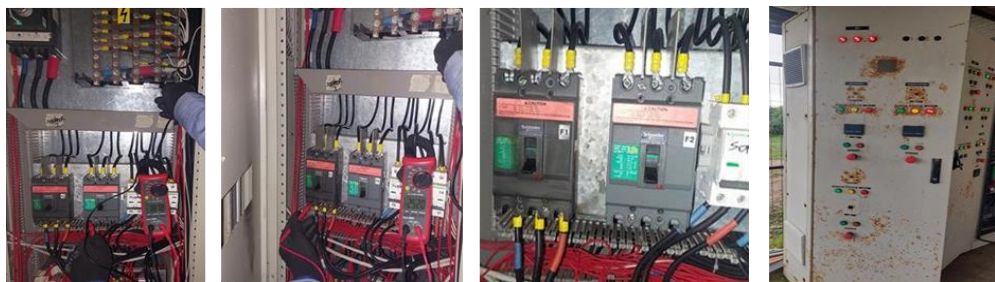
Figura 8-27: Fotos tableros eléctricos planta de tratamiento de aguas servidas
