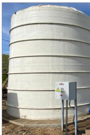
Figura 8-6: Estanque agua cruda
