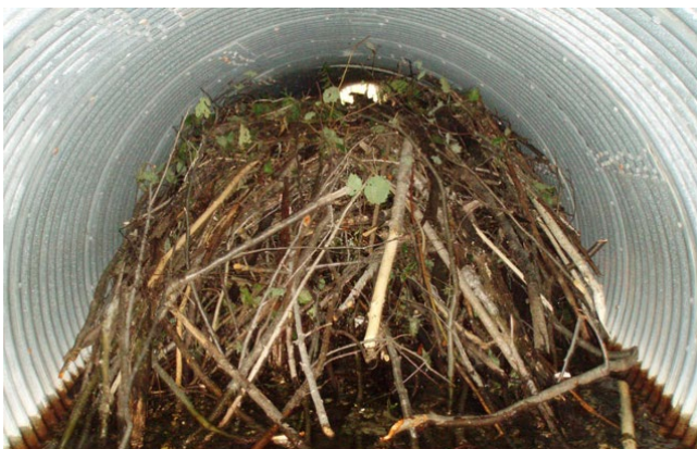
Figura C8. 9. Obstrucción de atraveso tipo alcantarilla por material leñoso. Fuente: https://ilmenvironments.com/
