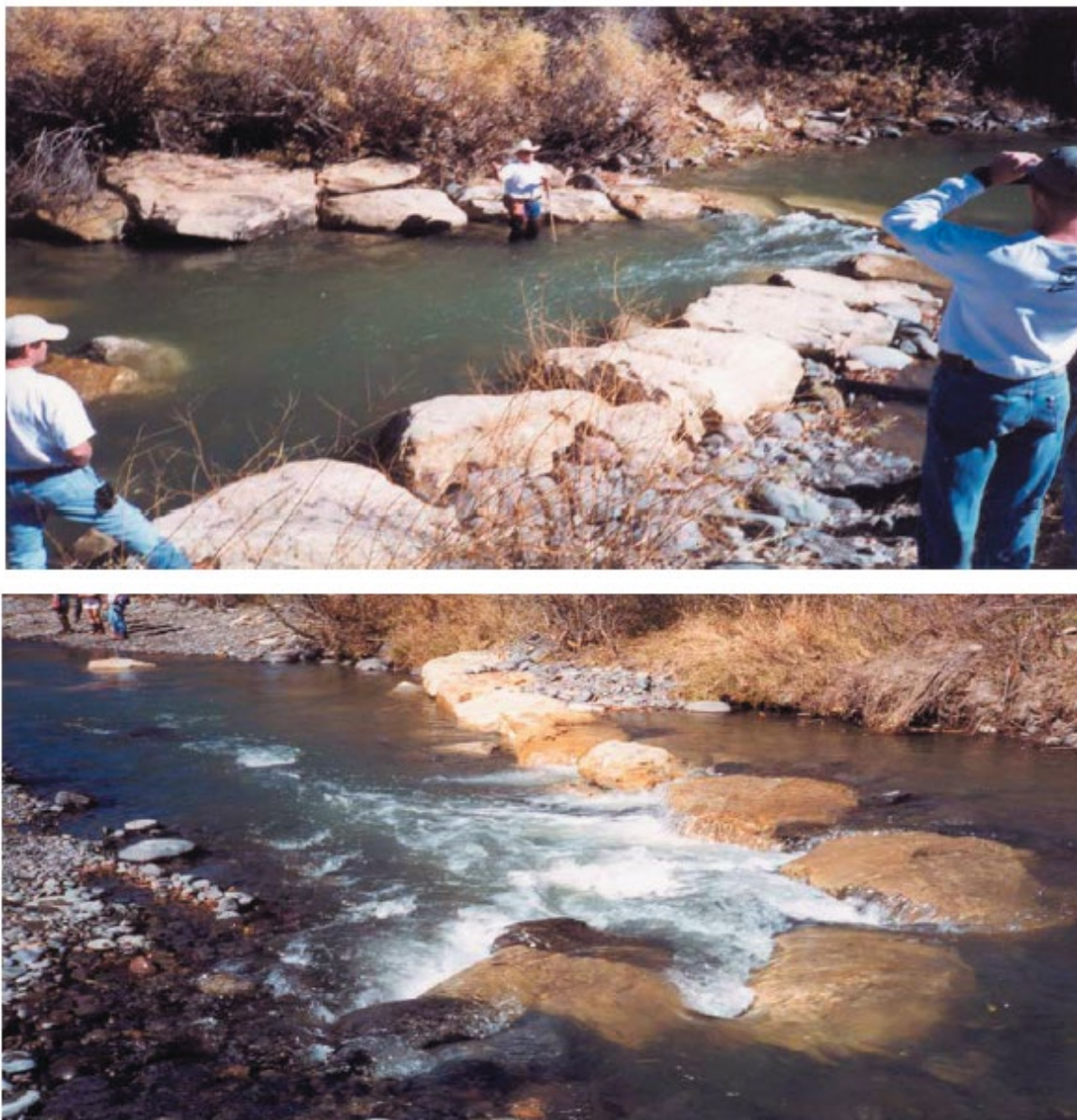
Figura C8. 37. En este sitio se ocuparon rocas de gran tamaño y bolones para un gradiente que atenuara la velocidad del agua Fuente: Bank Protection / Erosion Repair Design Guide. Chapter 1. Water Resources Infrastructure Protection Manual.
