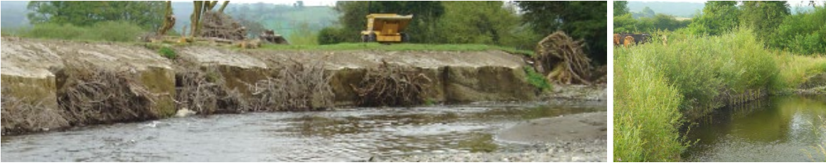
Figura C8. 46. Fotografía de orilla antes y después de la aplicación de tocones con raíz. Izquierda: inmediatamente luego de la instalación (marzo 2004). Derecha: Crecimiento de los tocones dos años después de la instalación (2006). Fuente: Manual of River Restoration Techniques
