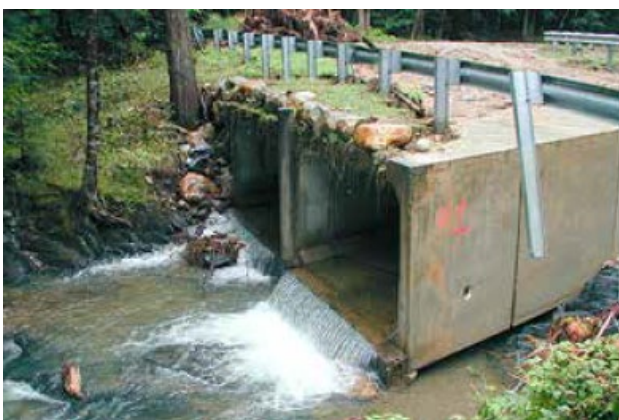
Figura C8. 8. Socavación en la zona aguas abajo de un traveso tipo cajón de hormigón. Fuente: Massachusetts Stream Crossing Handbook (Division of Ecological Restoration, 2012) .
