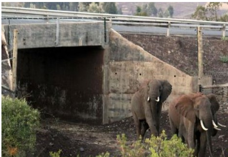
Figura C8. 49. Ejemplo de pasos de fauna bajo nivel en Kenia en el continente africano (derecha). Fuente: www.paiscircular.cl
