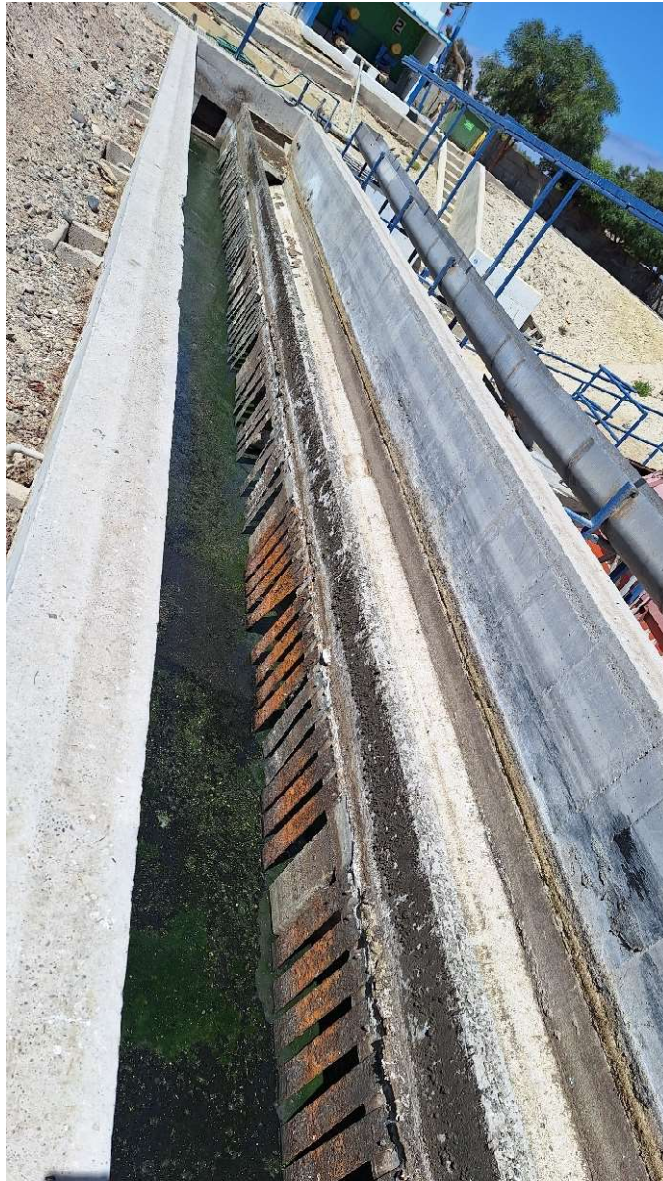
Figura 4.5: Obra Nueva Atacama-Sistema Caldera Chañaral, PTAS Caldera. Obra con calificación 4 en hoja 1801 y calificada con 1 en Auditoría.
