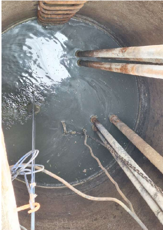
Figura 4.4 Obra Nuevo Sur-Sistema Pelluhue-PEAS Mariscadero Obra con calificación 4 en hoja 1801 y calificada con 2 en Auditoría- la PEAS ya que posee una sola bomba (no cuenta con bomba de respaldo).
