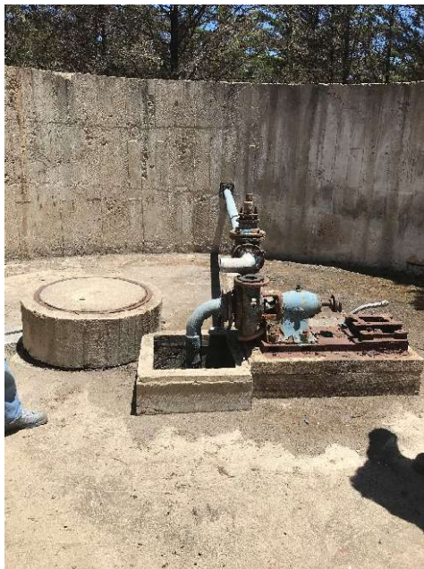
Figura 4.3: Obra Esval-Sistema Litoral Norte - Noria Pozo Hincado 1. En operación según NBI y fuera de uso en Auditoría.
