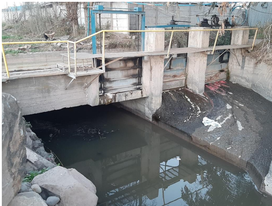
Figura 12: Compuertas canal Lo Espejo cerradas
