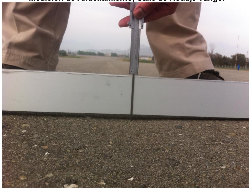
Figura N° 3-6 Medición de Ahuellamiento, Calle de Rodaje Tango.
