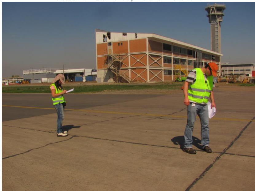
Figura N° 3-7 Catastro Deterioros, Plataforma Sierra.
