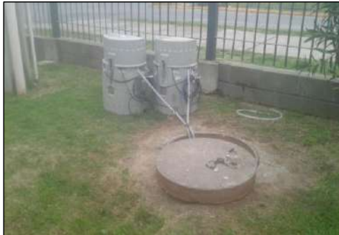
Fotografía 2: Equipo Automático Instalado
