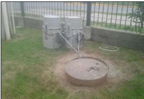
Fotografía 2: Equipo Automático Instalado
