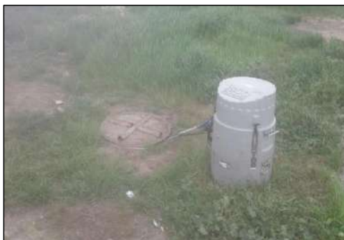
Fotografía 2: Equipo Automático Instalado
