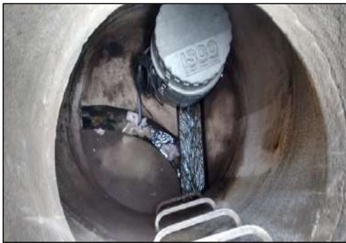
Fotografía 2: Equipo Automático Instalado
