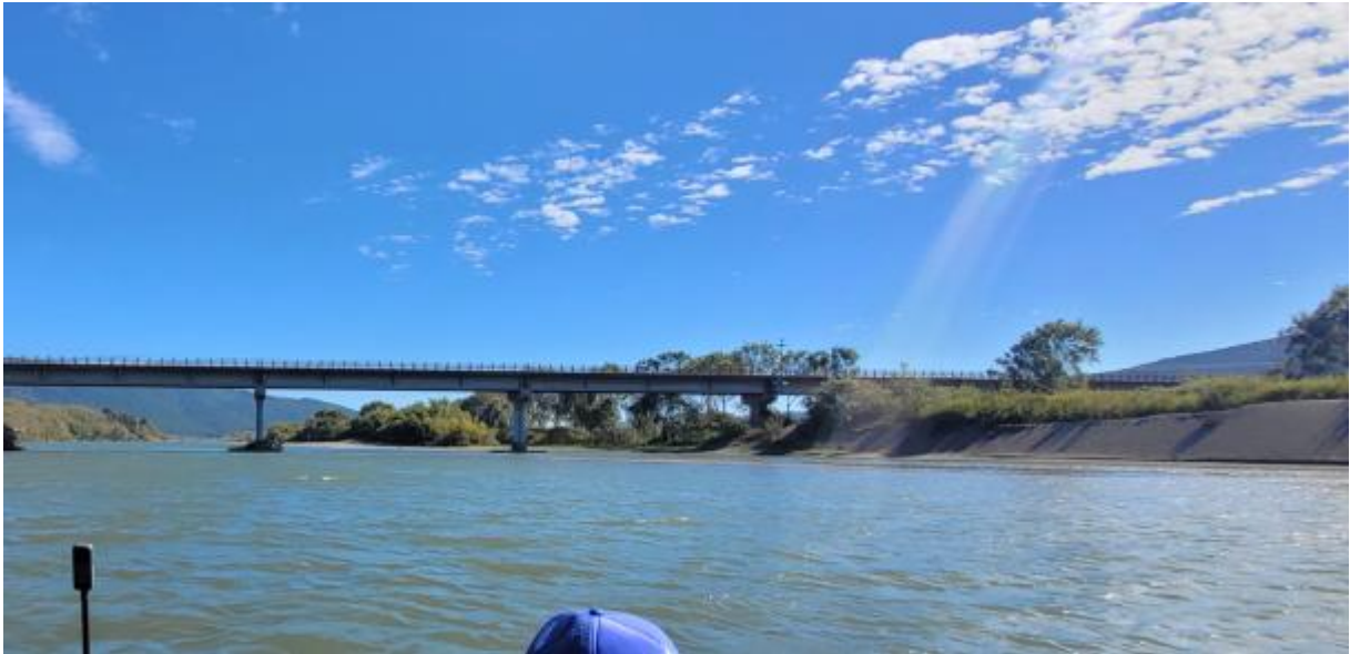
Figura 4-36: Bancos de arena en ribera norte del puente Lautaro. Imagen tomada en la campaña de terreno de Marzo 2024.
