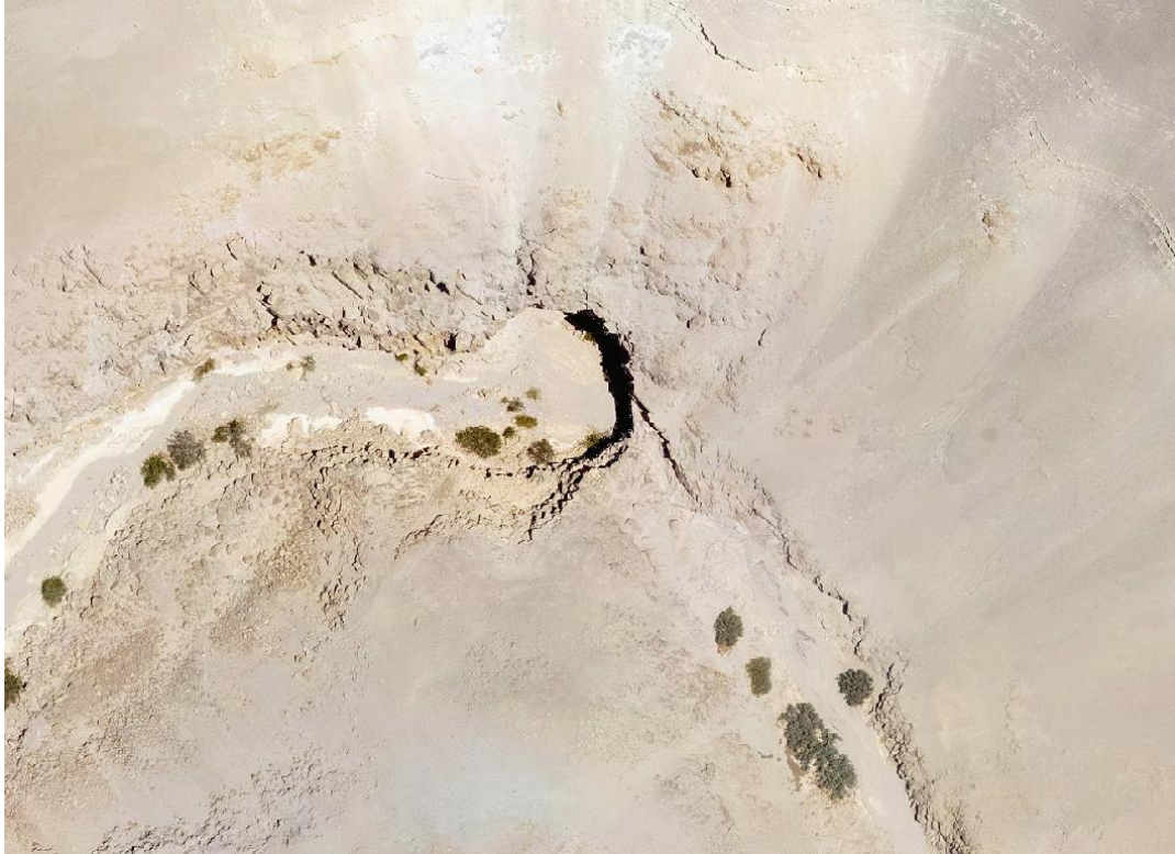
Figura 5-7. Vista en Planta de Caída existente en el sector S3, km 5.0
