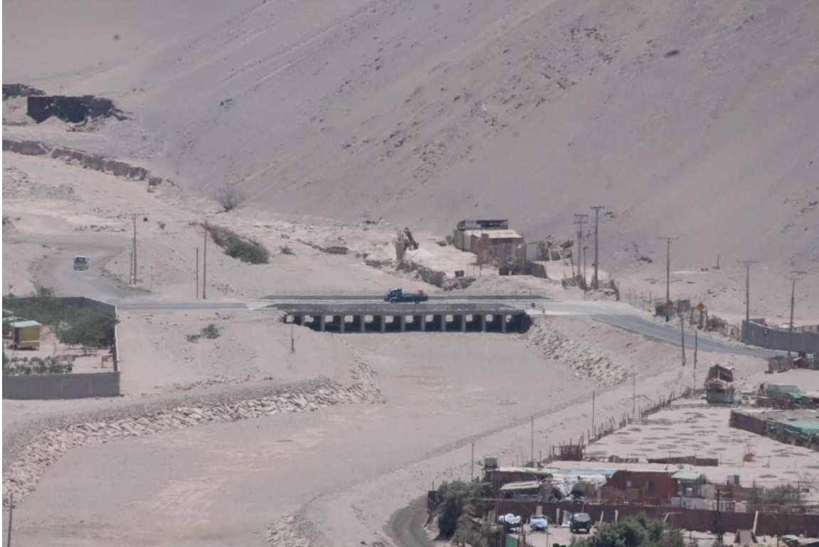
Figura 7-5. Vista de enrocado aguas abajo de puente vial ubicado en Ruta A-301
