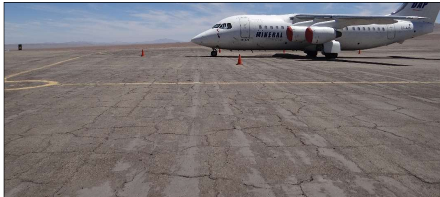
Figura 135: Deterioros Sección Plataforma PL-1.
