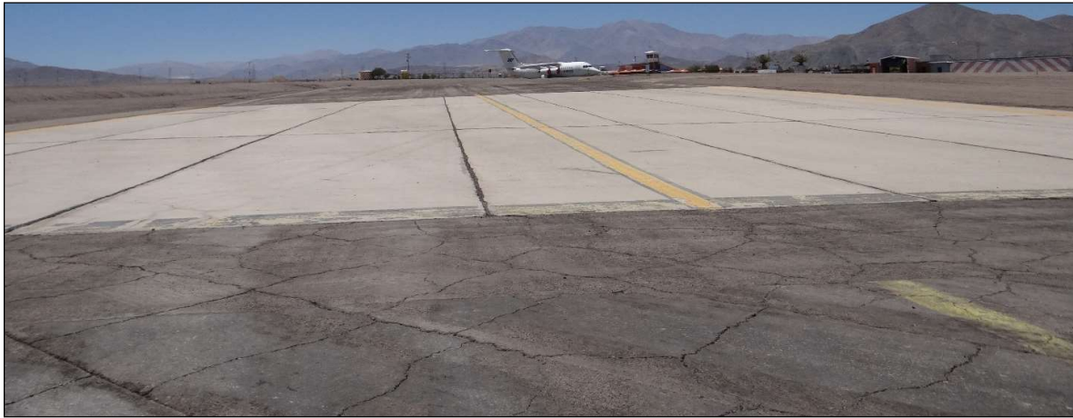
Figura 134: Deterioros Sección Rodaje Bravo CR-C.
