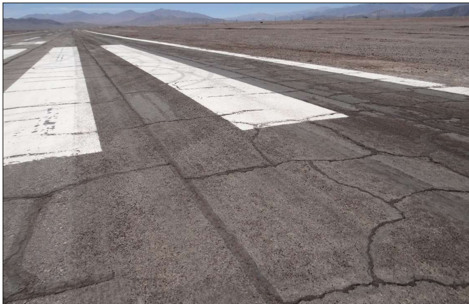
Figura 131: Deterioros Sección Pista MPI-1.
