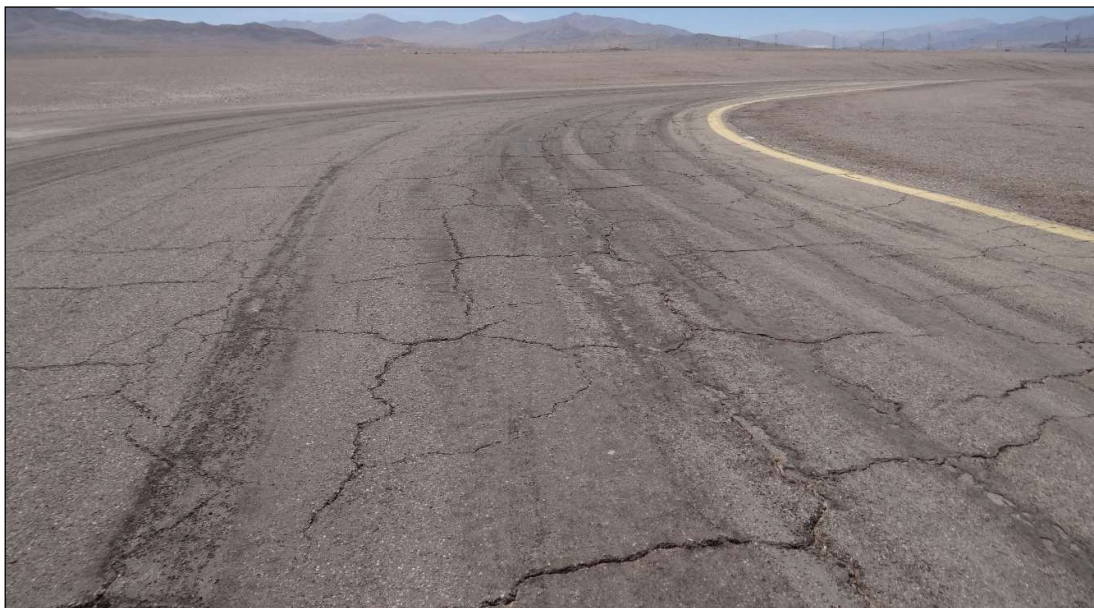
Figura 132: Deterioros Sección Rodaje Alfa CR-A.
