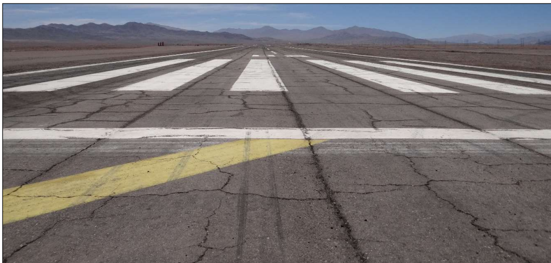
Figura 130: Deterioros Sección Pista PI-1.
