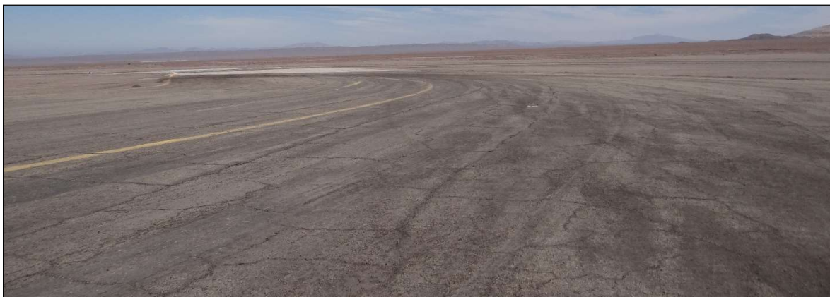
Figura 133: Deterioros Sección Rodaje Bravo CR-B.
